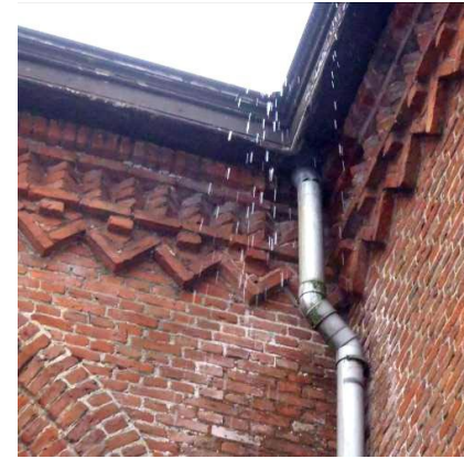
Figuur 74 vervuilde goten
