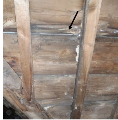
Figuur 32 viering [3] / [4]: ingerotte en beschimmelde bebording
