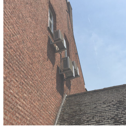
Figuur 96 storende latere toevoeging van HVAC installatie
