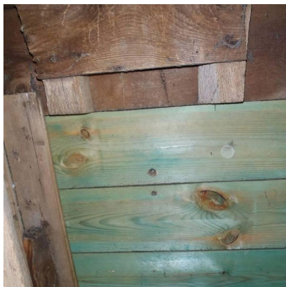
Figuur 45 toren [1]: doorgezaagde kepers zonder raveelconstructie
