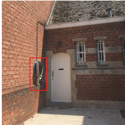
Figuur 95 storend oplaadpunt elektrische auto en betonnen plaat er voor
