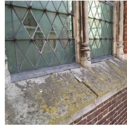
Figuur 50 uitgespoelde stootvoegen
