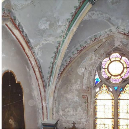
Figuur 116 vleugel [8] - noordwest: beschadigde afwerk- klaag door oude en recentere lekken
