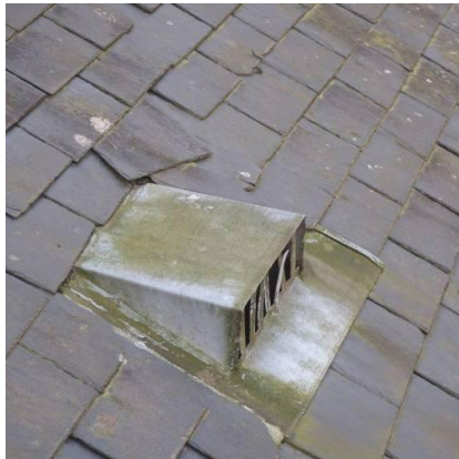
Figuur 44 dak [8], [11] en [13]: licht verweerde verlichtingen
