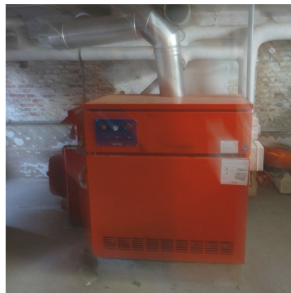
Figuur 157 nieuwe pastorie: recent vernieuwde verwarmingsinstallatie in kelder
