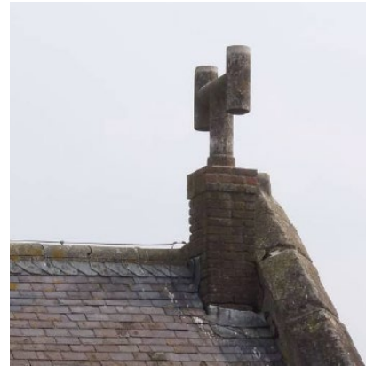
Figuur 41 dak [6]-topgevel: verweerd vezelcementen (asbesthoudend) trekstuk
