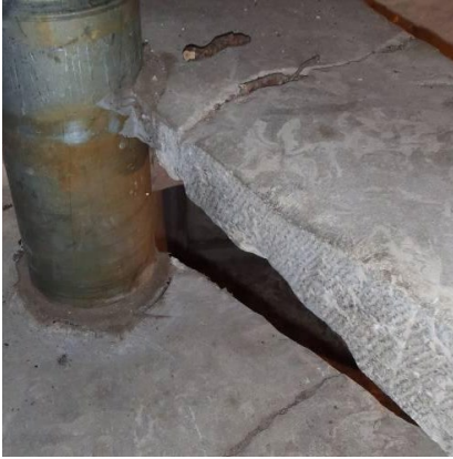
Figuur 124 kapotte treden in de traptoren en doorboring van de droge blusleiding naar de zolders
