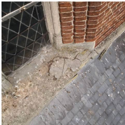
Figuur 52 beschadigde raamafzaat
