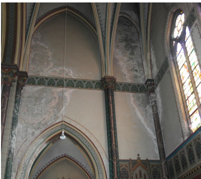
Figuur 113 vochtschade aan zuidelijk transept
