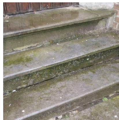
Figuur 59 beschadigd voegwerk van de treden
