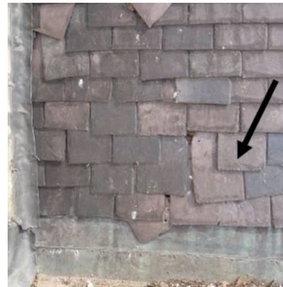
Figuur 33 dak [10] - west: weggevallen leien
