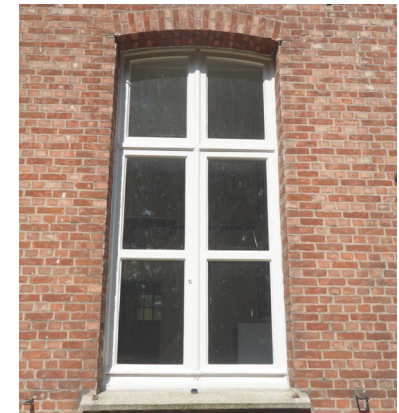
Figuur 91 ramen; achtergevel nieuwe pastorie ontbrekende luiken
