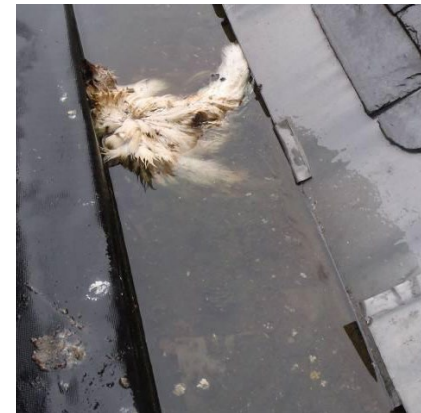
Figuur 75 vervuilde goten
