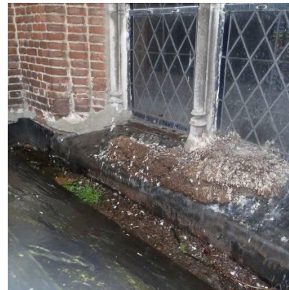
Figuur 73 vervuilde goten
