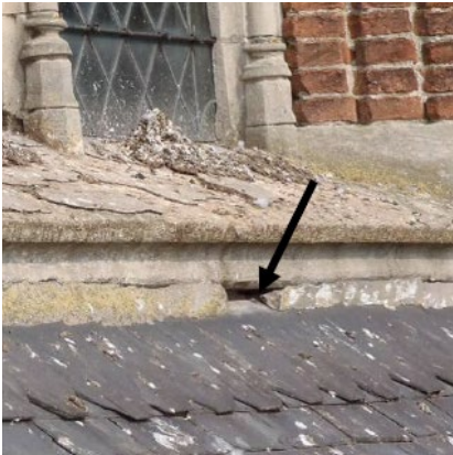
Figuur 37 schip [3]: weggevallen aanwerkmortel
