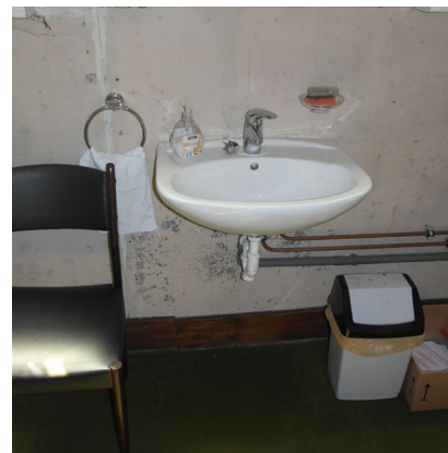
Figuur 149 sacristie: sanitaire installatie
