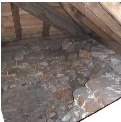
Figuur 105 torenvoet [1] - zuidwest: sterk beschadigd metselwerk
