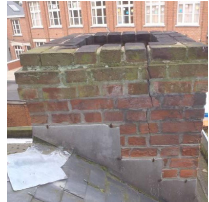
Figuur 43 dak [13]: uitgespoeld voegwerk bovenaan
