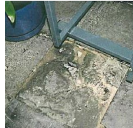
Figuur 122 afgeschilferde vloertegels in noordelijke dwarsbeuk
