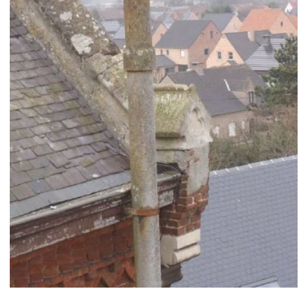
Figuur 42 dak [4] - oost: vezelcementen (asbesthoudende) schoorsteenpijp
