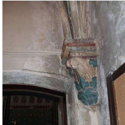
Figuur 118 plaatselijk beschadigde plafondafwerking door lekken
