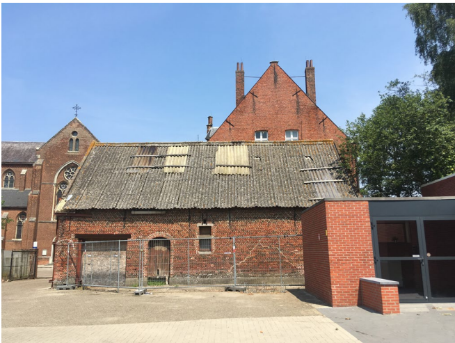
Figuur 239 vervallen bijgebouw
