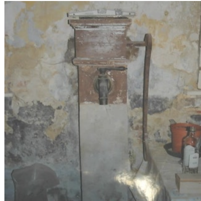
Figuur 187 waterpomp in schuur pastorie
