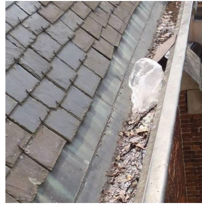
Figuur 72 vervuilde goten
