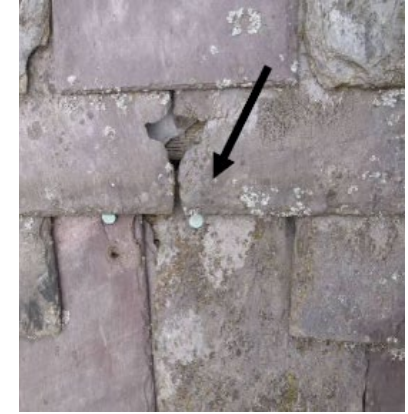
Figuur 34 beschadigde en weggevallen leien
