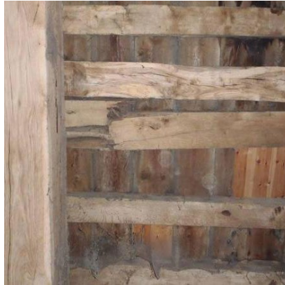
Figuur 104 uurwerkzolder: gebroken kinderbalken
