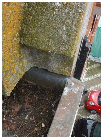
Vleugel [1]-zuidwest: openstaande aansluiting.
