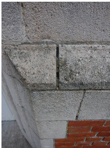
Uitgespoelde stootvoeg van de plint.
