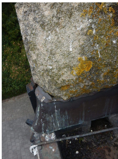
Vleugel [1]-noordwest: openstaande aansluiting.
