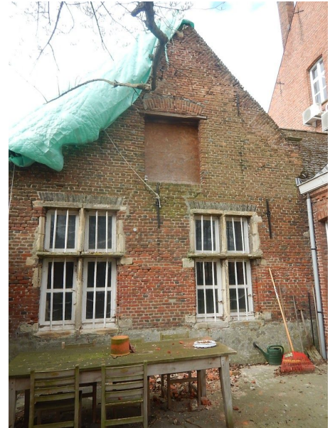
Bouwvallige gevel aan de tuinzijde.
