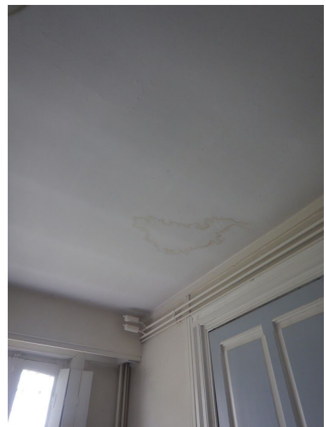
Vleugel [3]: vochttafeking aan de binnenzijde.
