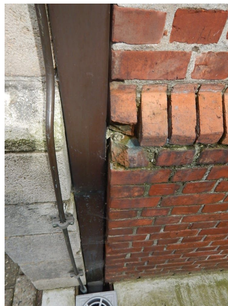
Uitgespoelde stootvoeg van de plint.
